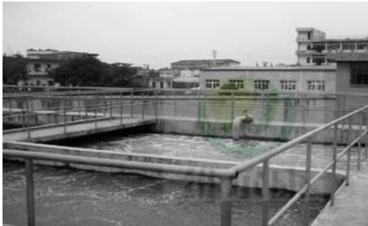
黑龙江某药业公司废水治理工程项目
