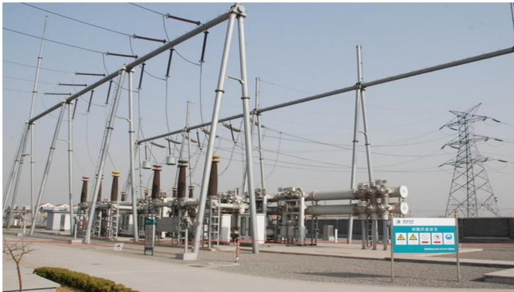
浙江省变 110KV 输变电工程项目
