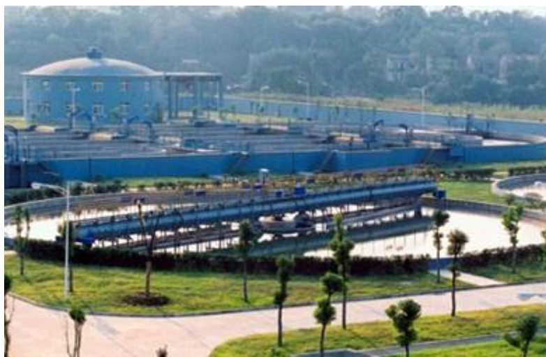
河北省某公司废水处理改造项目
