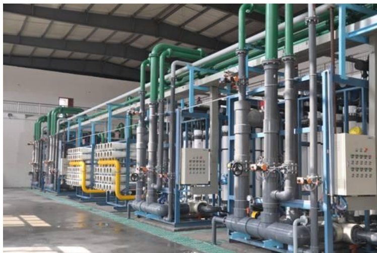
黑龙江煤化工废水处理项目
