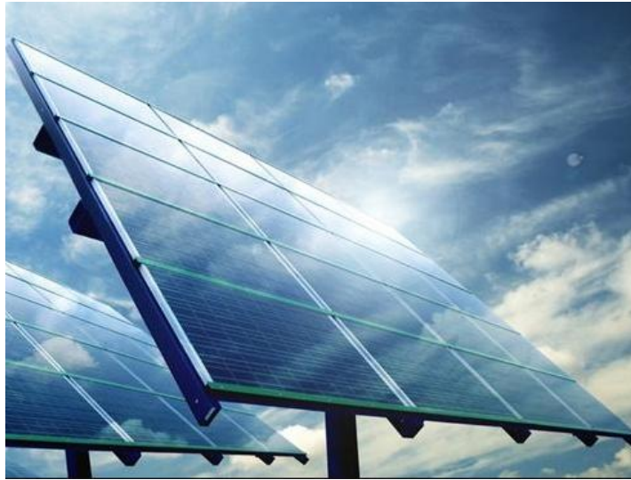
保加利亚某光伏发电项目
