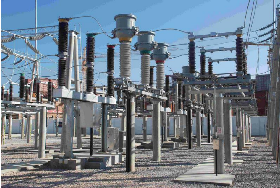
江西省 110kV 某变输变电站工程项目
