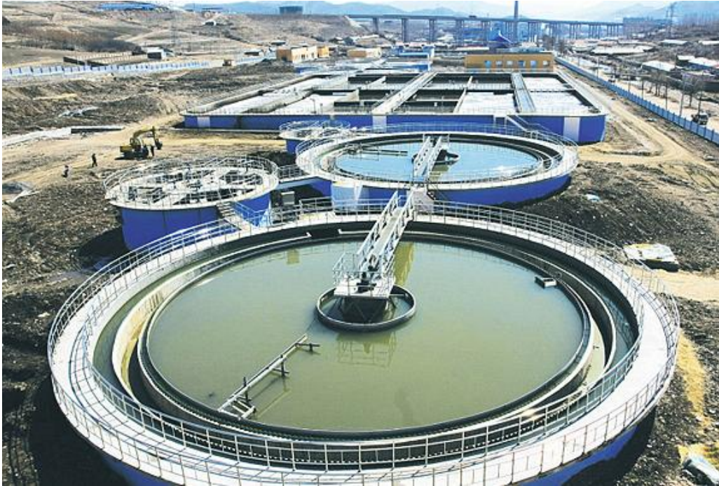
黑龙江某药业公司废水处理工程项目
