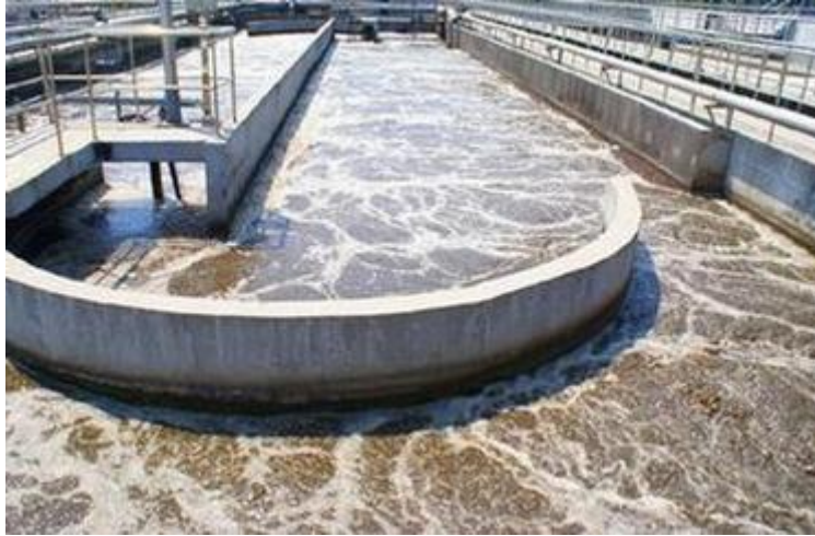
江苏省污水处理厂废水处理及回用工程项目
