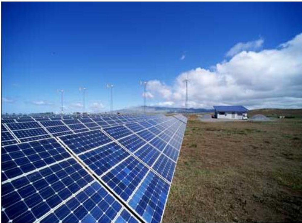
西藏 20MWp 光伏并网发电项目
