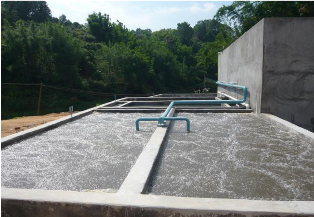
江西省某污水治理项目
