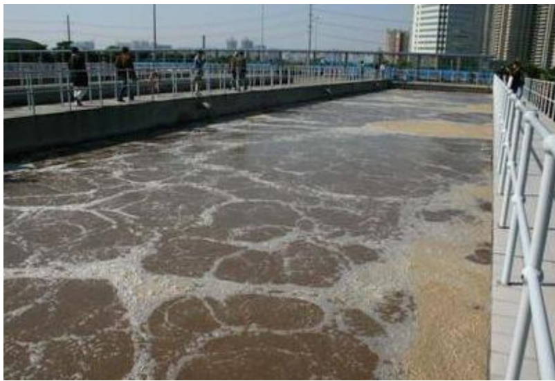
天津某小区污水处理项目
