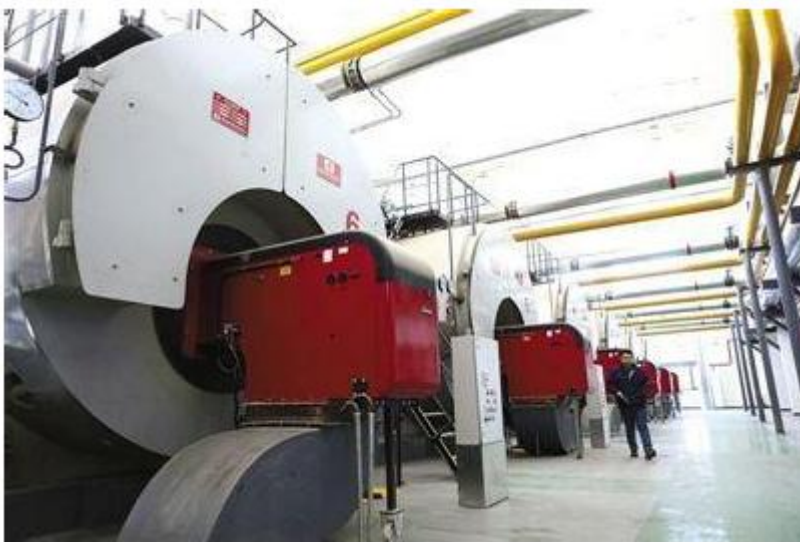
天津某地燃气锅炉供暖项目
