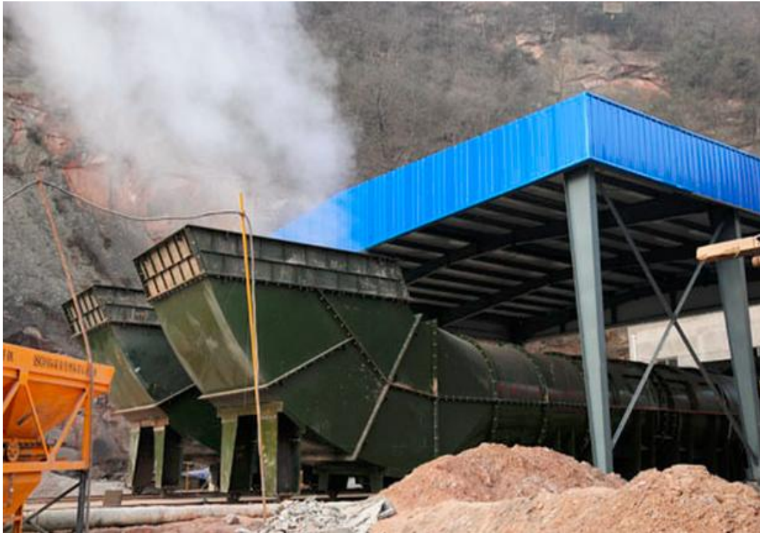
陕西省煤矿通风机项目
