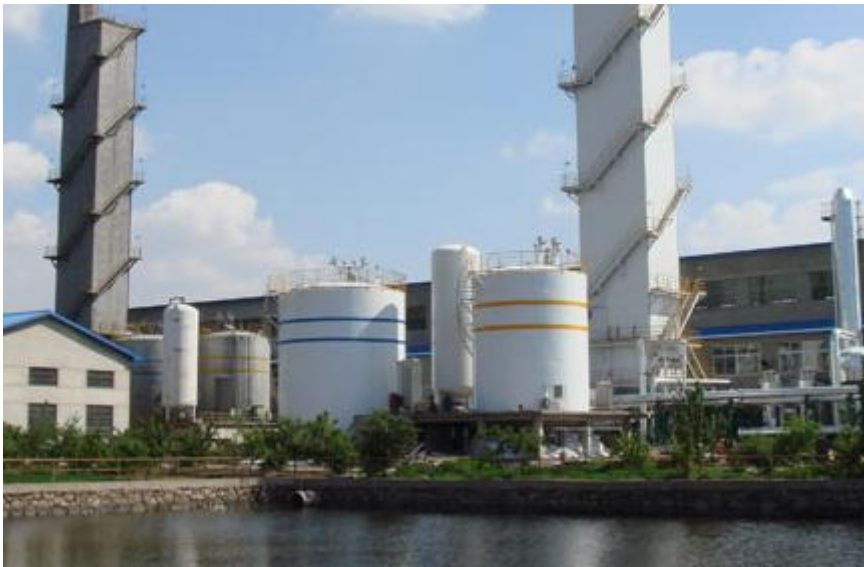
深圳某公司新型制氧项目
