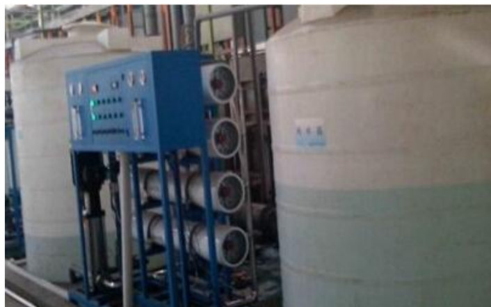
浙江某稻草浆污水回收项目项目
