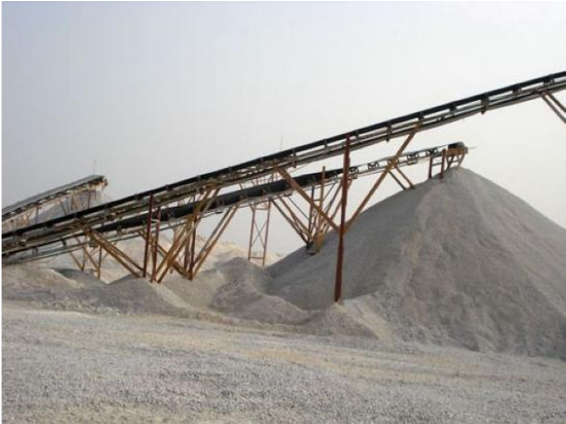
福建某机制砂石生产项目
