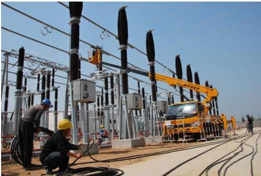
湖北某 110kV 输变电工程项目
