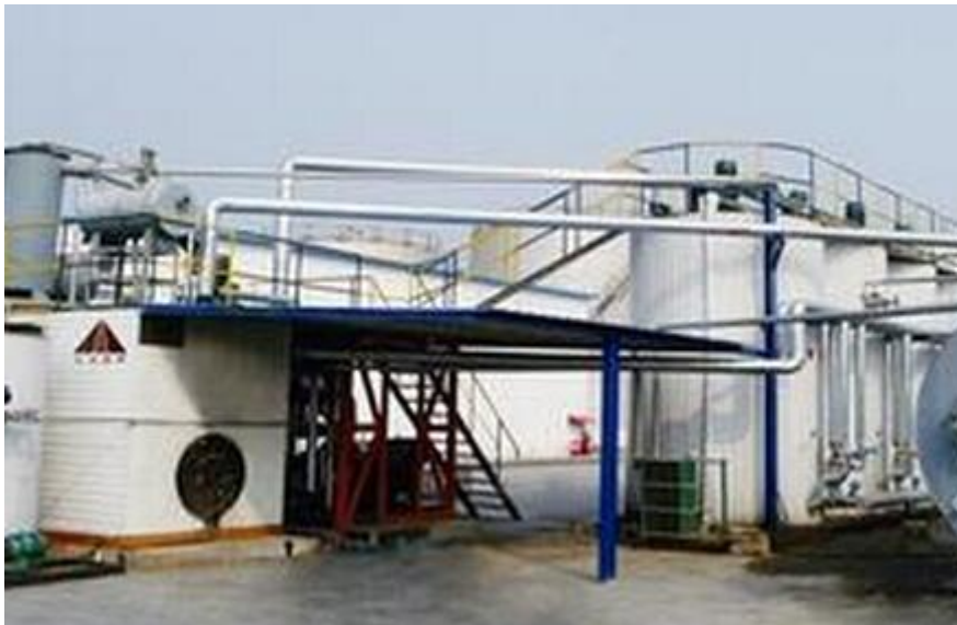
黑龙江某改性沥青、乳化沥青项目
